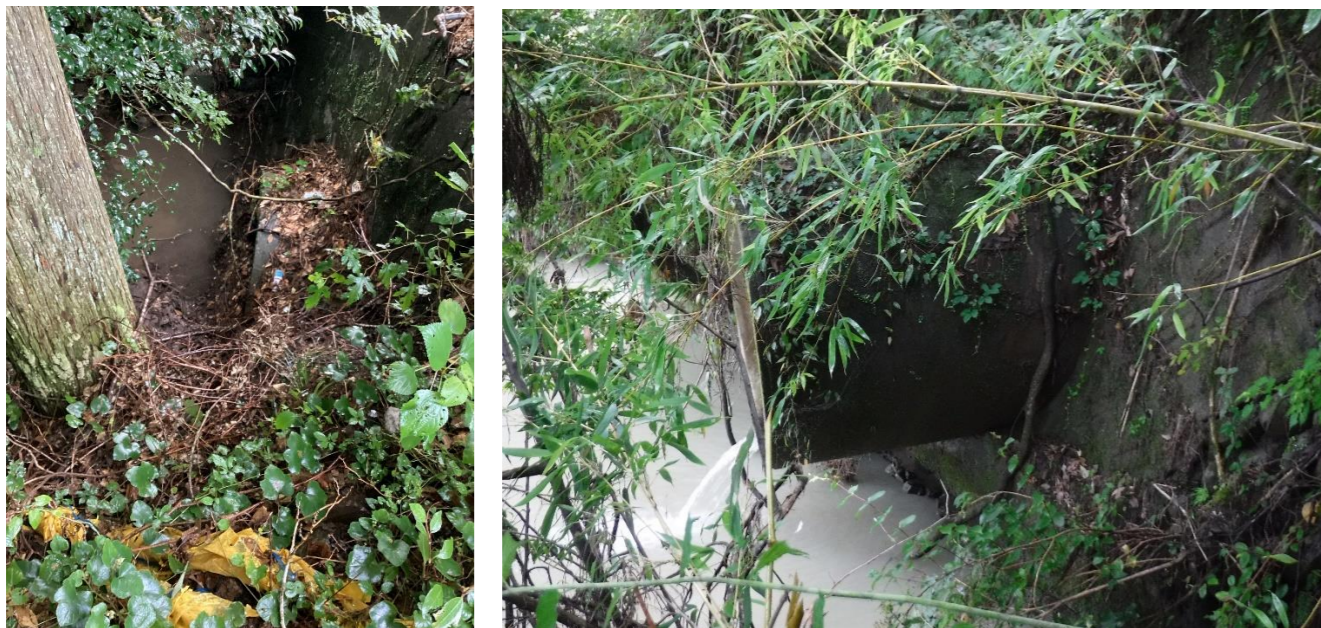
図 6 道路横断水路、北側エリア・ヒューム管φ1500（左：建設候補地側入口、右：耳川側出口）
