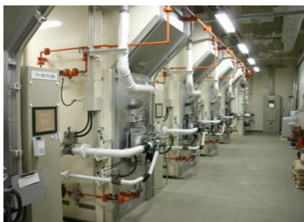
火葬炉運転室
