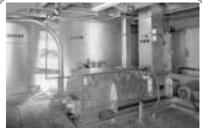
灰固形化設備 焼却灰を薬剤処理して固形化。重金属類の溶出を防ぎます。
