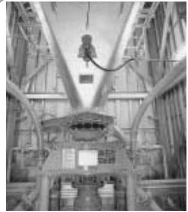
有毒ガス除去装置 排ガスに含まれた有害物質を、消石灰と活性炭で除去します。
